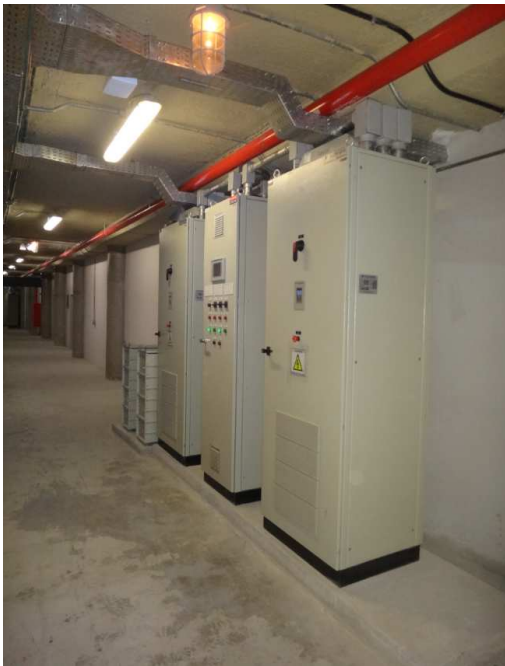
Figura 8 - Painéis elétricos e de automação
