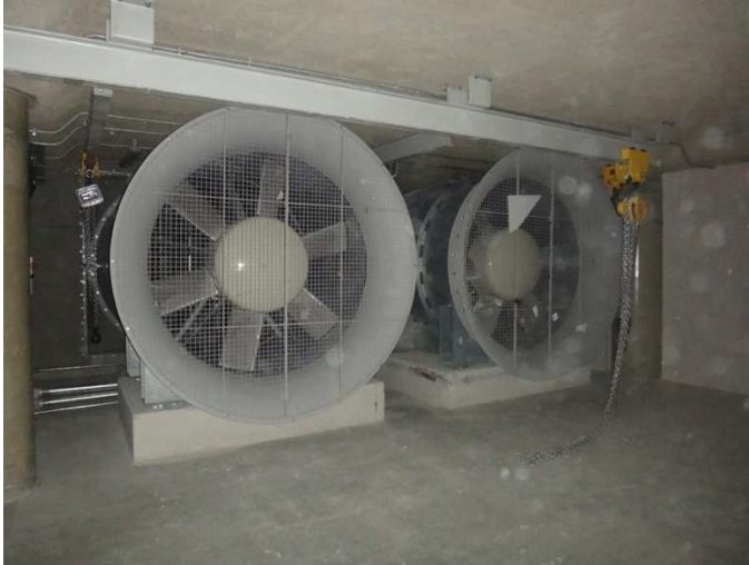
Figura 14 - Ventiladores axiais (demonstrando as restrições de área para instalação de equipamentos)
