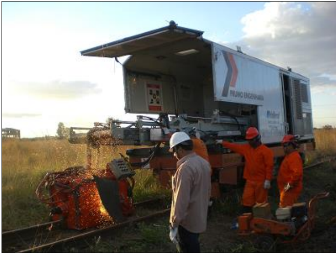
Figura 3 - Container de soldagem elétrica (Thiago Viana, 2011)
