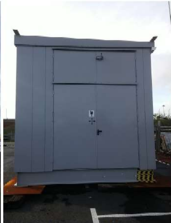
Figura 3: Vista Lateral Eletrocentro
