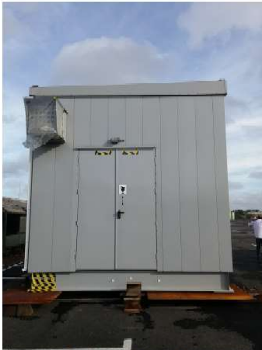
Figura 2: Vista Lateral Eletrocentro
