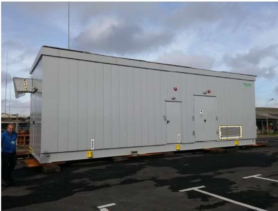
Figura 1: Vista Frontal Eletrocentro
