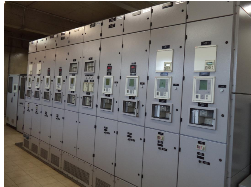
Cubículos de Média tensão 22 kV
