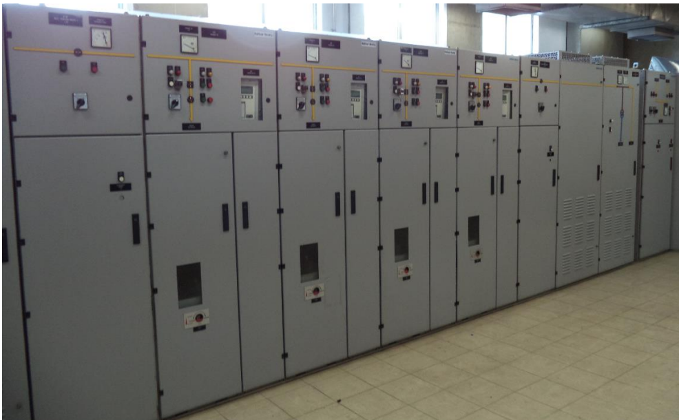
Cubículos de Tração - 1500 Vcc
