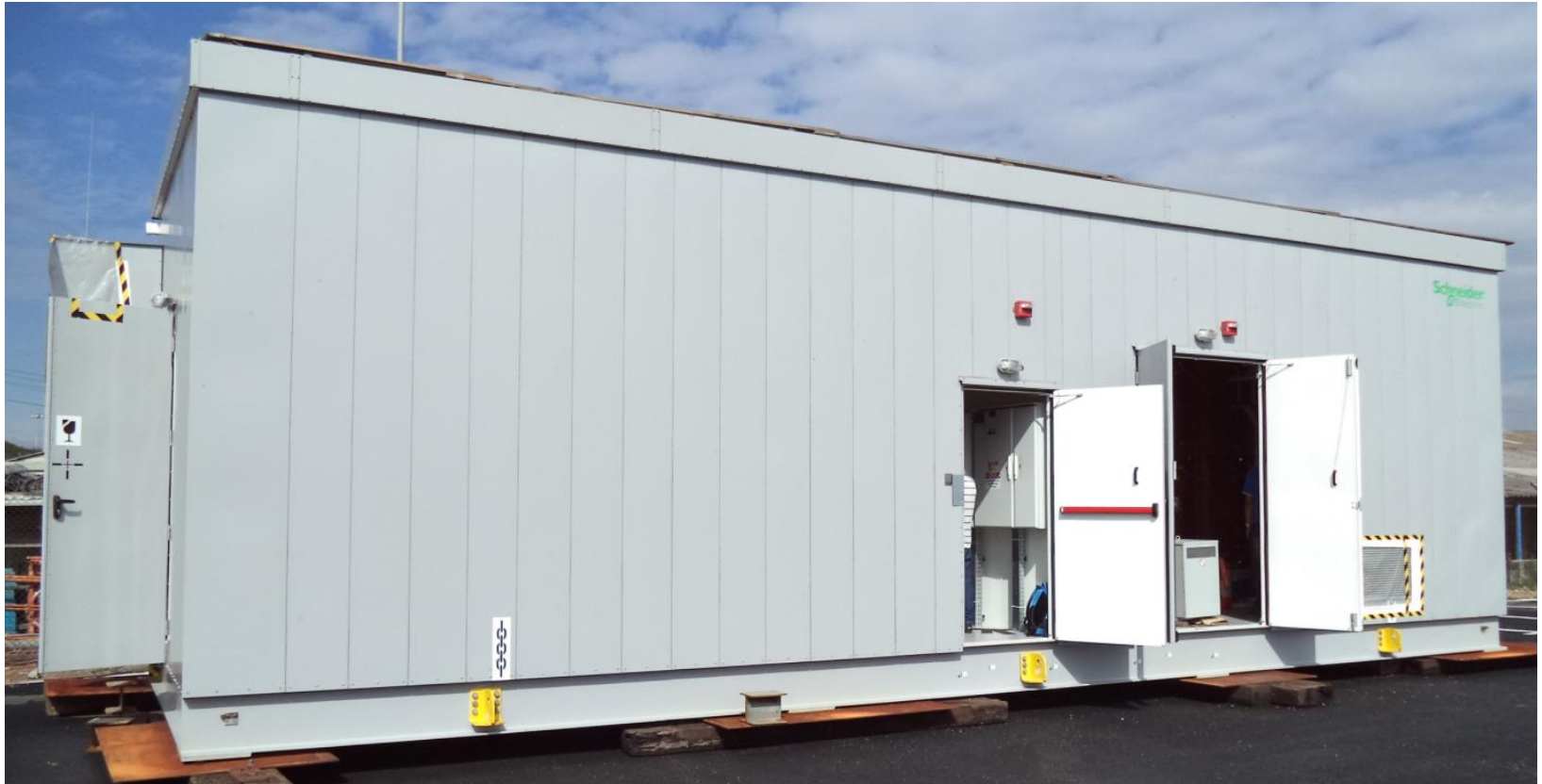
SUBESTAÇÃO RETIFICADORA “FLEX” E TEMPORÁRIA
