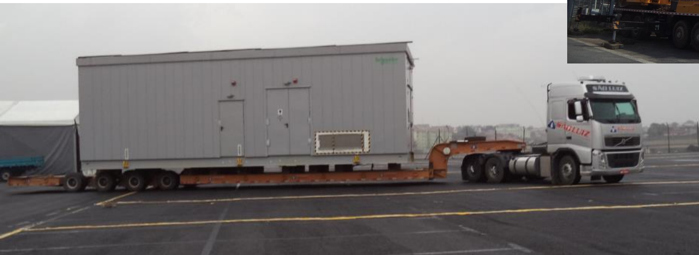
SUBESTAÇÃO RETIFICADORA “FLEX” E TEMPORÁRIA
