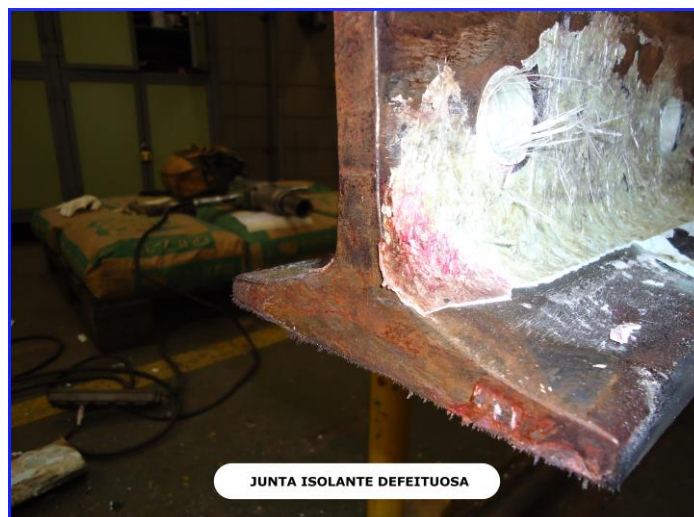
Figura nº16- Junta isolante defeituosa
