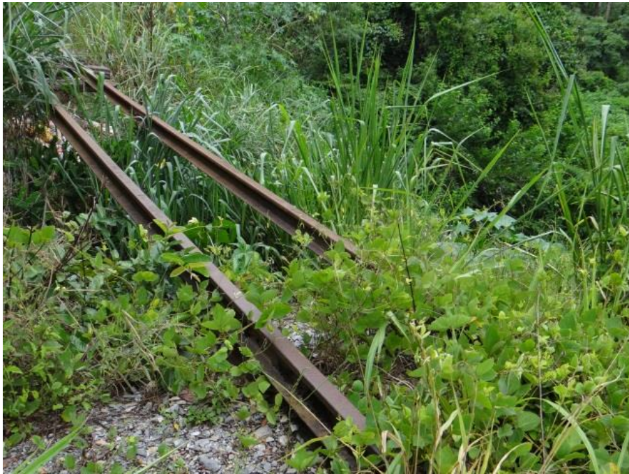
Figura 12: Trecho com Problemas Erosivos. Fonte: (Autores, 2016).
