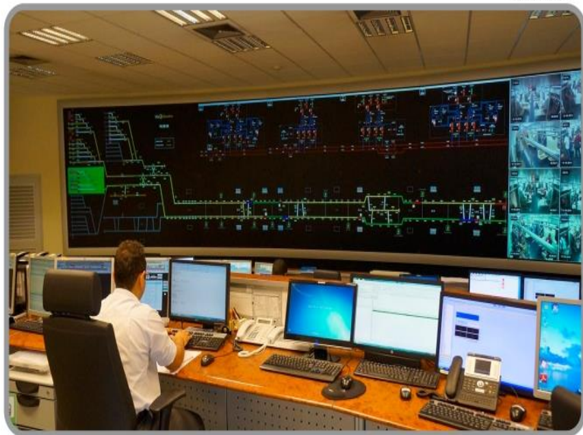
CCO da Linha 4 - Amarela do Metrô de São Paulo
