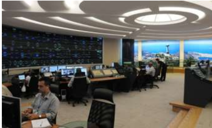
CCO do Metrô do Rio de Janeiro (Foto Metrô Rio)
