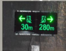
Sistema de Rota de Fuga
