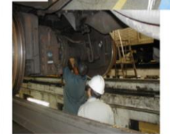
MONITORAMENTO DO SISTEMA DE DETECÇÃO / EXTINÇÃO INCÊNDIO
