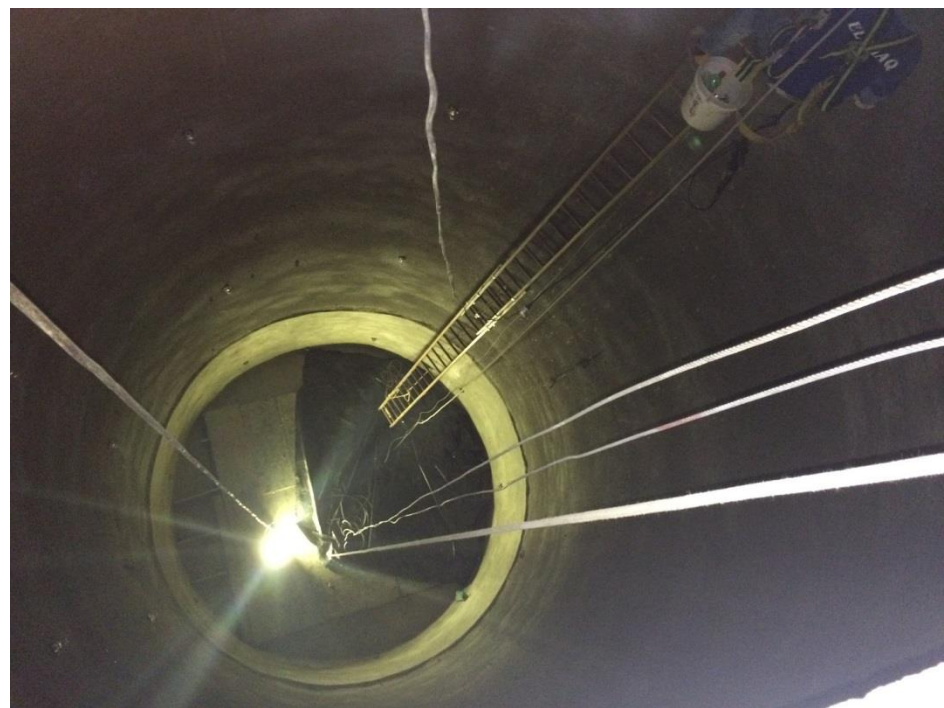
Figura : Poço de acesso à equipamentos - PAE
