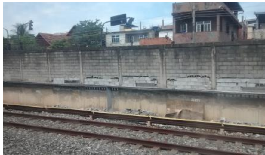
Trecho do bandejamento preso ao muro na Linha 2 do MetrôRio
