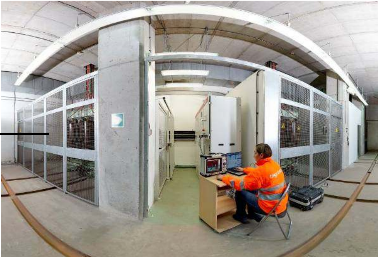
Sistema Ingeber instalado subestación Ripa
