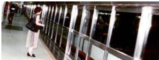
Portas de Plataforma
