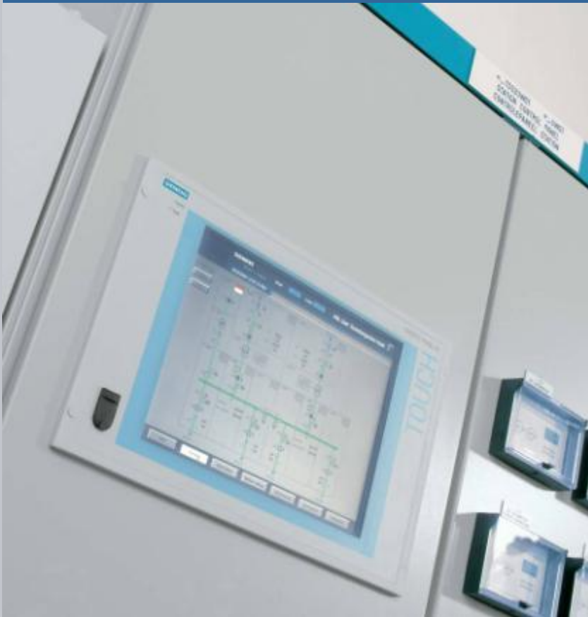
Sistema de controle da Estação -Sitras® SCS-AC
