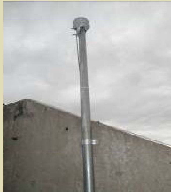
Vista do sensor ultrassônico WS-200 fixado na estrutura
