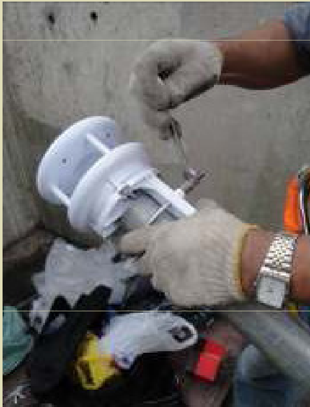
Instalação do sensor ultrassônico WS-200 na tubulação de aço galvanizado no topo do mastro.
