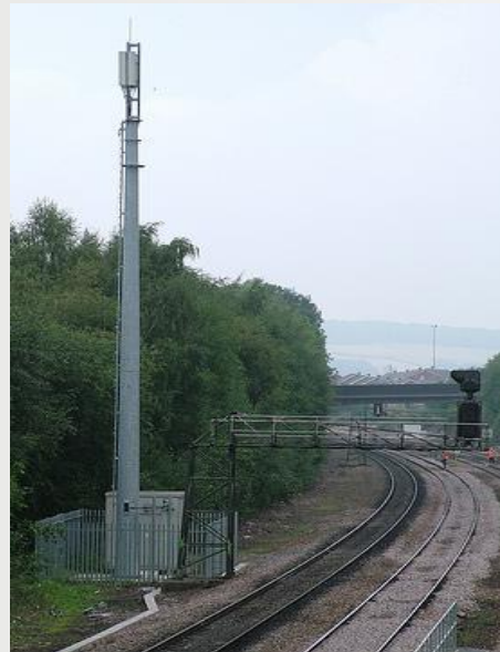
Estação rádio-base GSM-R
