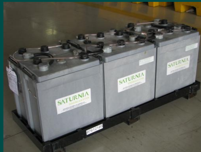
Conjunto de Baterias Chumbo-ácidas (Monoblocos de 175 e 200 Ah)
