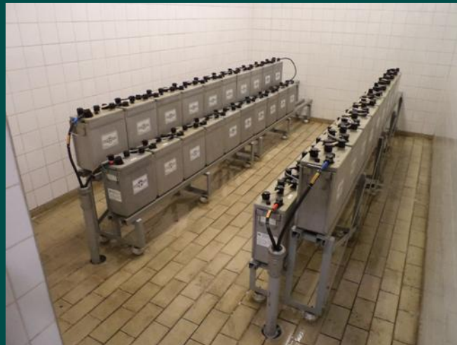
Conjuntos chumbo-ácidos de 125 Volts formados por monoblocos de 175 Ah
