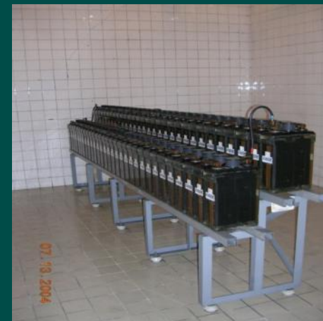
Conjunto de Baterias Chumbo-ácidas 60 elementos 150 Ah
