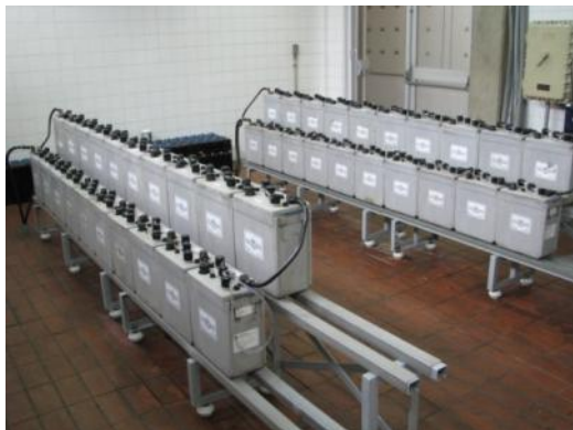
Figura 5: Conjuntos de 20 monoblocos 11TMF 175-3 Instaladas em março/2013
