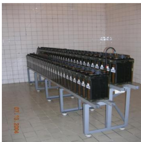
Figura 1: Conjunto de Baterias Chumbo-ácidas (60 elementos 150 Axh)
