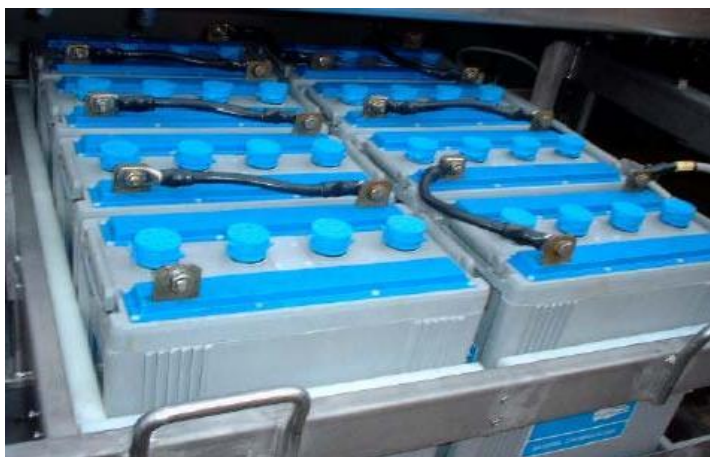
Figura 2: Conjunto de Baterias dos Trens da Frota F – Linha 5 - Lilás
