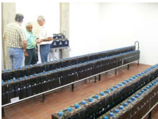
Figura 4: Conjuntos de Baterias Alcalinas (192 elementos 136 Axh)
