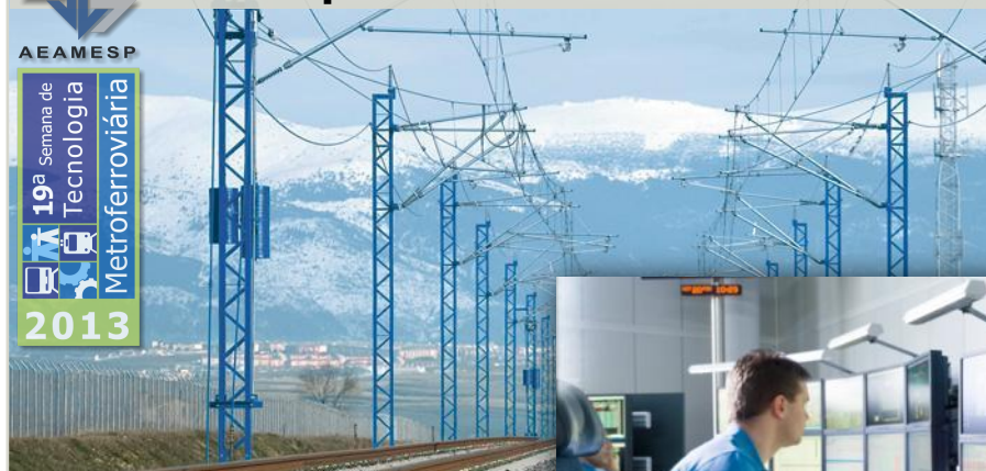
Rede Aérea para Ferrovias
