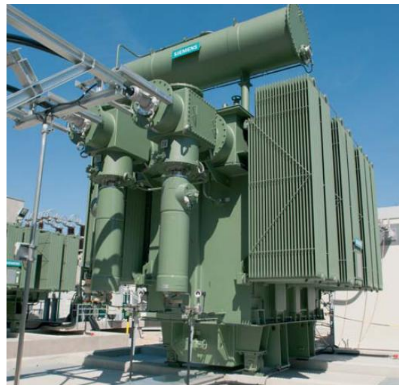
Transformador de Tração
