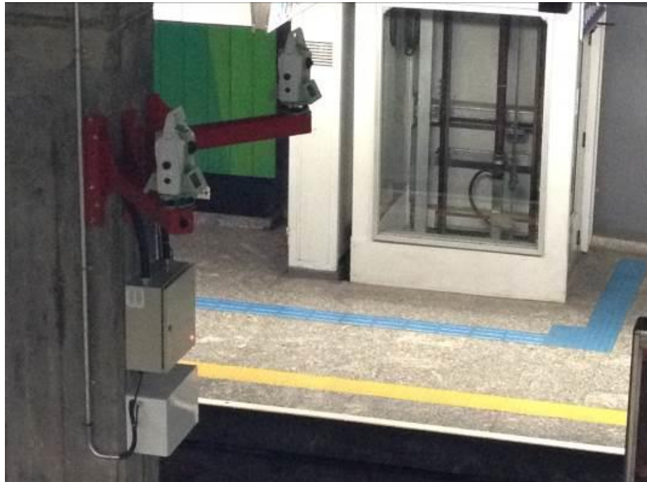
Figura 7: Estações Totais, Caixa de comando e abrigo do No-Break
