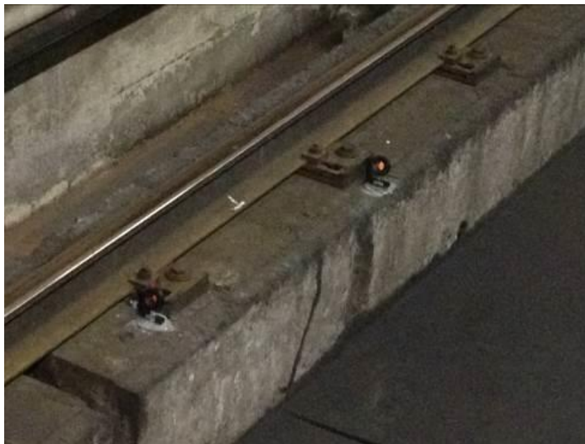
Figura 6: Prismas instalados na via permanente
