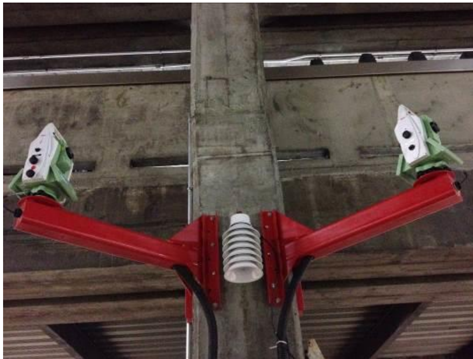
Figura 5: Estação total robótica fixada no pilar entre vias da Estação
