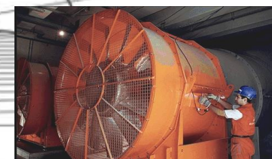
Equipamento de estação
