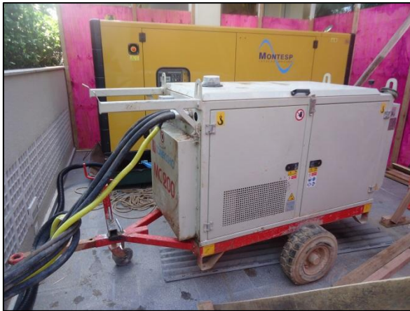
Figura 11 – Gerador e Centralina
