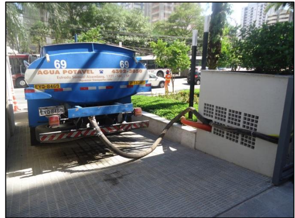
Figura 12 – Abastecimento de água
