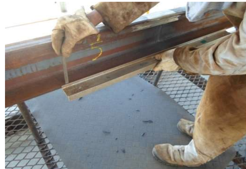
Verificação do desalinhamento do patim
