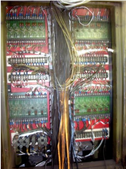
Fiação e Placas de Interface (antigas)
