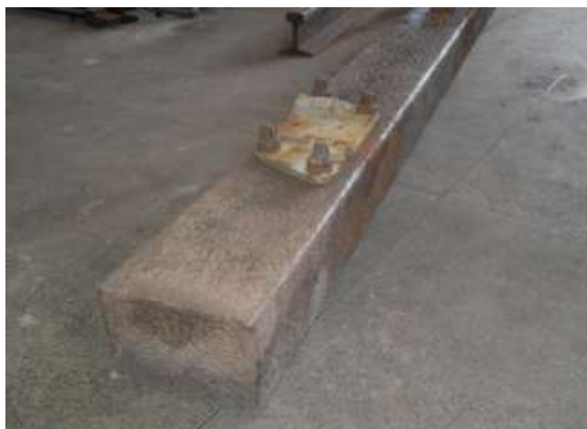
Figura 9: Dormente polimérico aplicado em AMV, Região da Grade do Jacaré, 2006. Retirado do trecho em 2015, para ensaio de torque da fixação conforme norma AREMA.
