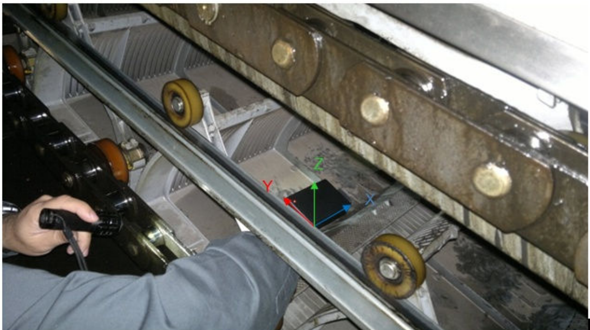
Figura 3 – Analisador instalado em uma ER.
