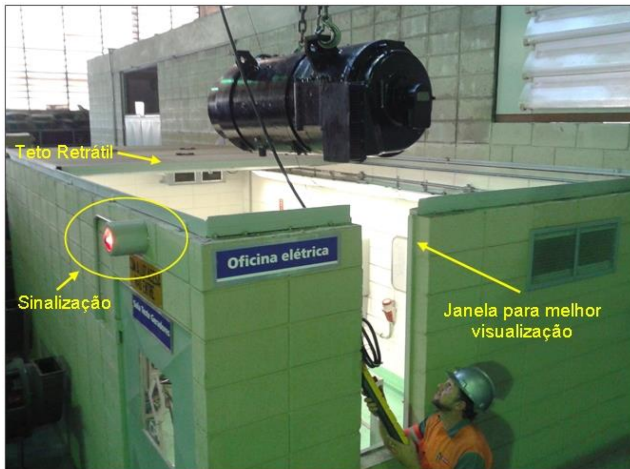
Movimentação de Gerador para o interior da Sala de Testes por teto retrátil
