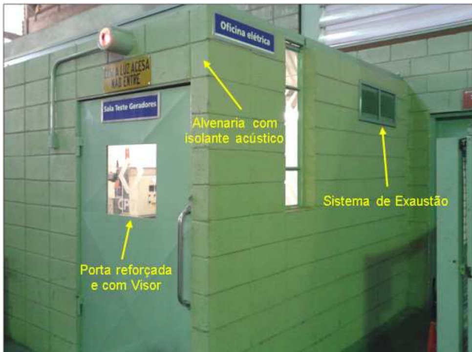
Sala com Isolamento Acústico para Testes de Geradores e Motores Auxiliares
