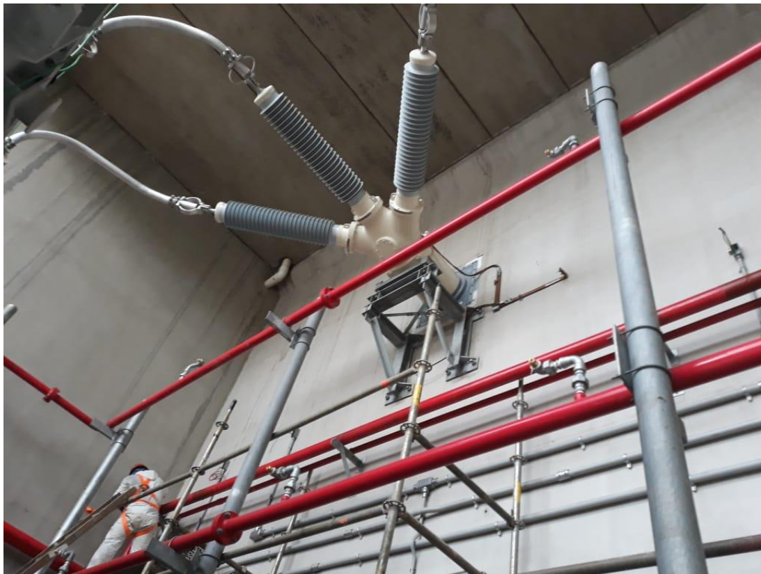
Bucha Alta Tensão Transformador 2
